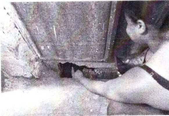
Rachaduras e a abertura do solo surgiram no residencial Vale do Mundial localizado no bairro
