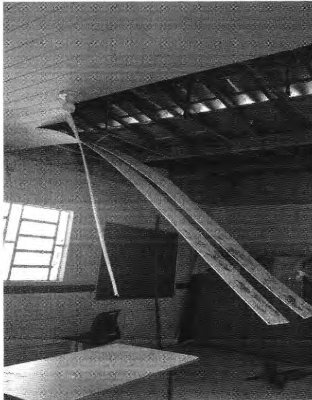
Forro danificado, coberta com infiltrações
