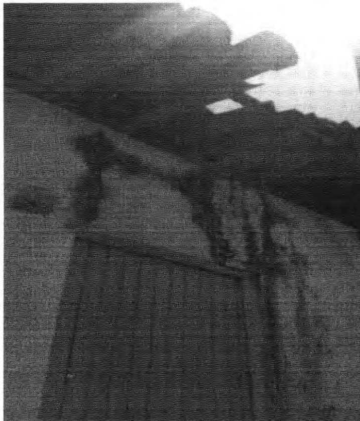
Coberta , pintura e hidráulica danificadas
